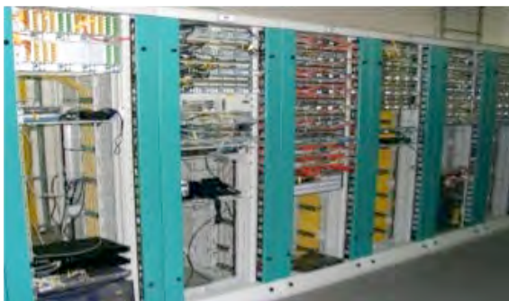
Knoten WR (LRZ-Gebäude)
